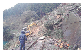
荷稻～伊与喜間で発生した土砂崩壊の様子
